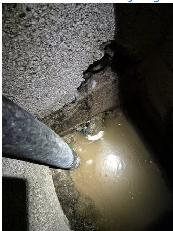
Slika 3: Zamašitev kanalizacijskega sistema
