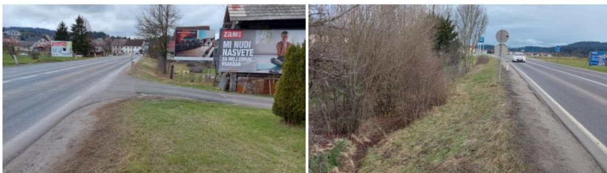
Slika 6: Dostop 2 in obstoječi jarek ob glavni cesti – pomanjkanje infrastrukture
