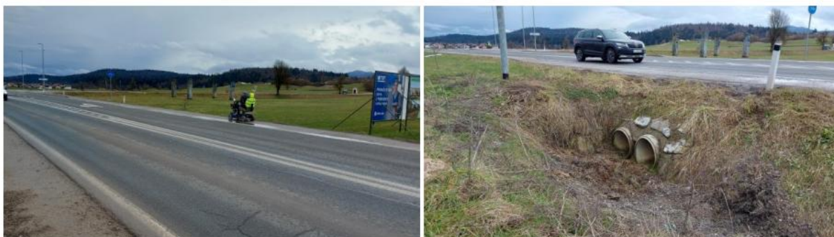
Slika 7: Poškodovano vozišče in Prepust 3 in 4 - nevarna pot udeleženca v prometu
