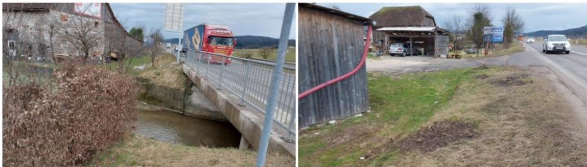
Slika 5: Most čez Logaščico in Dostop 1 – pomanjkanje infrastrukture
